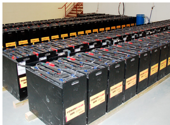
Rysunek 2.1. Zestaw akumulatorów o łącznej mocy 60 kW i stałym napięciu wyjściowym 480 V zainstalowany w korporacyjnym centrum obliczeniowym jako uzupełniające źródło zasilania. (Zgodę na publikację zdjęcia wydała firma Hybridne Power Systems Canada Inc. będąca właścicielem praw autorskich. Dalsza reprodukcja wymaga dodatkowej zgody ze strony wymienionej firmy)
